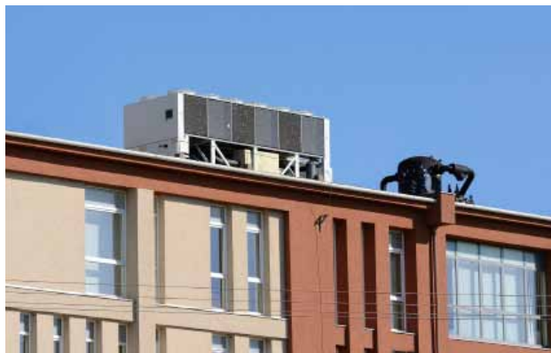
Traditionele installatie op het dak.
